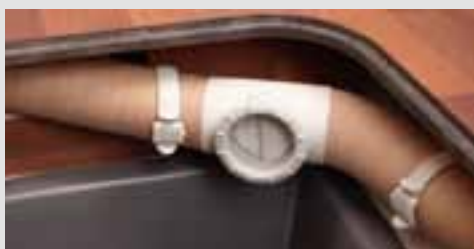
Bocchetta di aerazione nel doppio pavimento
