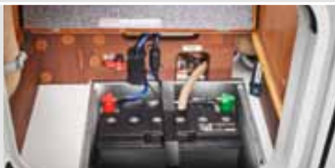
Centralina batterie nel doppio pavimento
