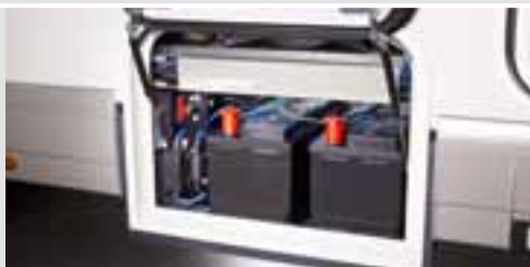
Centralina batterie nel doppio pavimento
